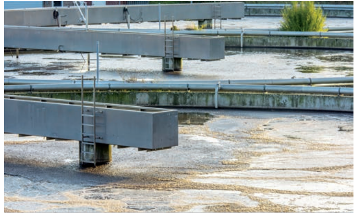
▲ Kläranlagen profitieren von gesenkten Verbrauchskosten bei der Schlammeindickung.
